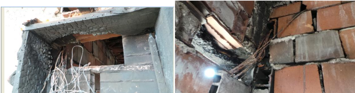
Слика 8. Траги на опожарување во орманот и ел.инсталација
